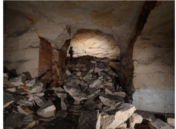
Instabilité du niveau supérieur
