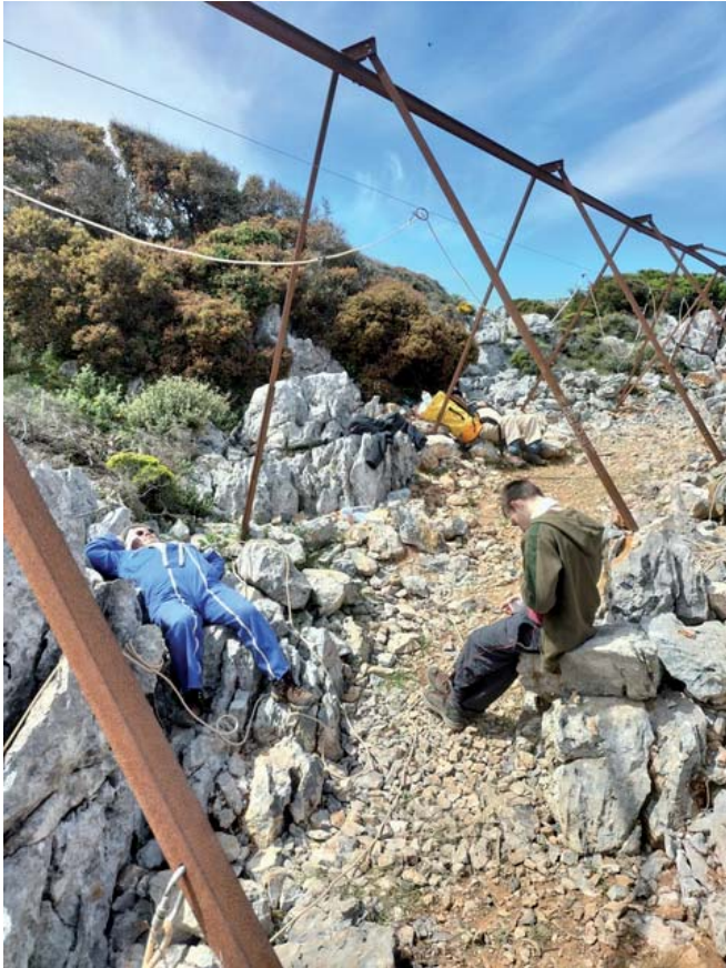
Rail de dégagement des bidons (photo D. Accorsi)
